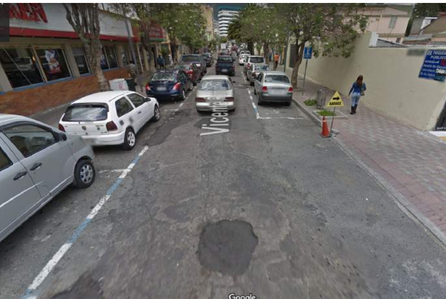
Existen vías que necesitan un arreglo ya que los baches reparados y los trizados afectan a la fluida movilización de los vehículos y el cruce peatonal.
