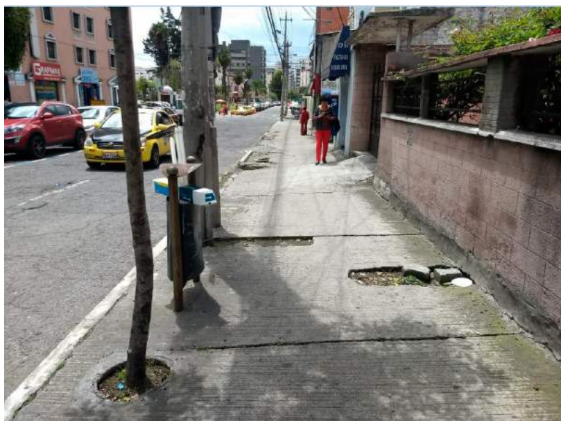
Acera en malas condiciones y en proceso de deterioro, que no permite una caminabilidad buena ni universal. Foto tomada en la acera de la calle Ulpiano Páez, sector SRI.
