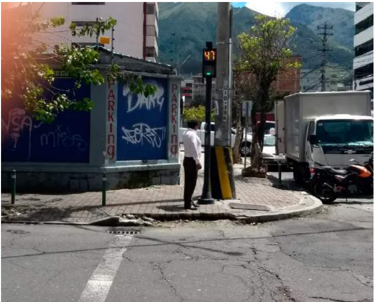
Cruce peatonal malo. Presencia de obstáculos en trayecto, déficit de rampa, mal estado de la materialidad, paso cebra no definido. Foto tomada en la calle Robles y 9 de Octubre. Fuente: Fotografía propia.
