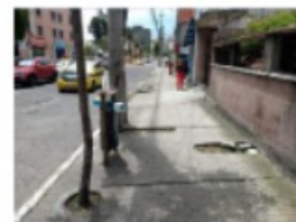
Acera en malas condiciones y en proceso de deterioro, que no permite una caminabilidad buena ni universal. Foto tomada en la acera de la calle Ulpius Pérez, sector 330.
