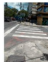
Cruce peatonal regular. Ramping no definidos y regular estado de la materialidad.
